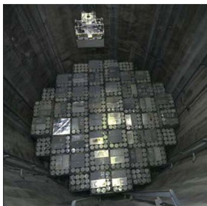
Stockage de déchets (radioactivité faible à moyenne) à Olkiluoto, Finlande. SKB, Suède
